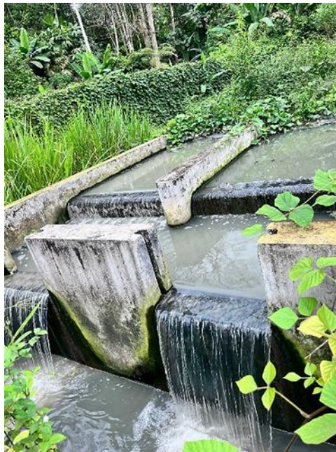
Imagen 22: Planta de tratamiento de aguas residuales
